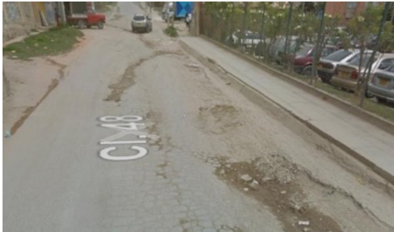
c. Avanzando por la calle 48 se encuentra la vía en pavimento rígido, aunque deteriorado, y visualmente se aprecia una pendiente considerable de ascenso. No se observa presencia de sumideros u otras obras de drenaje. Hay andén a un solo costado.
